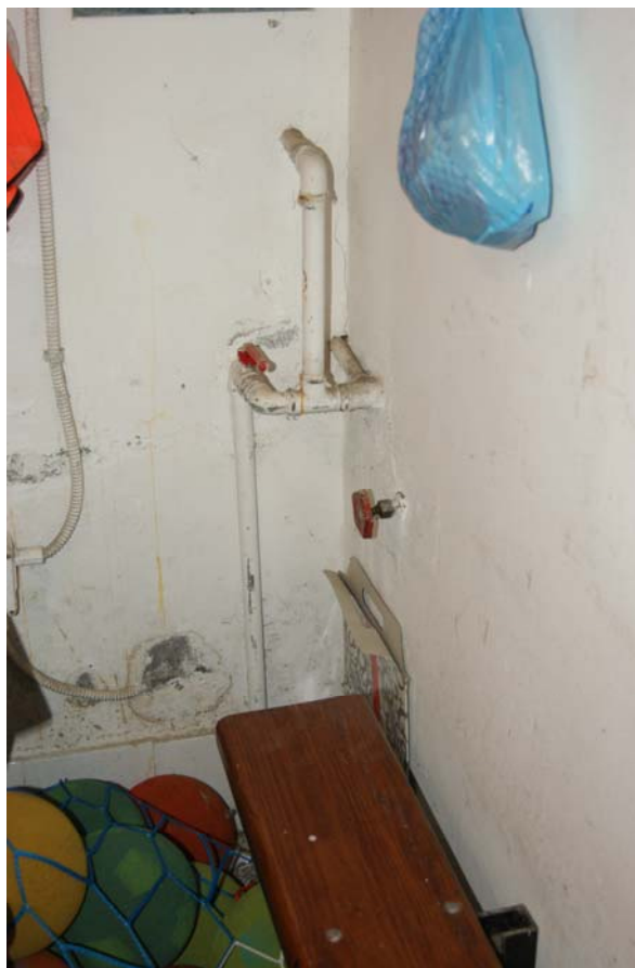
Arrivo acqua acquedotto esistente nel locale magazzino
