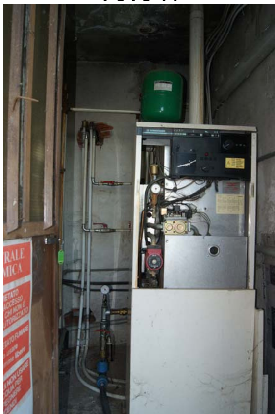
Caldaia esistente in C.T.
