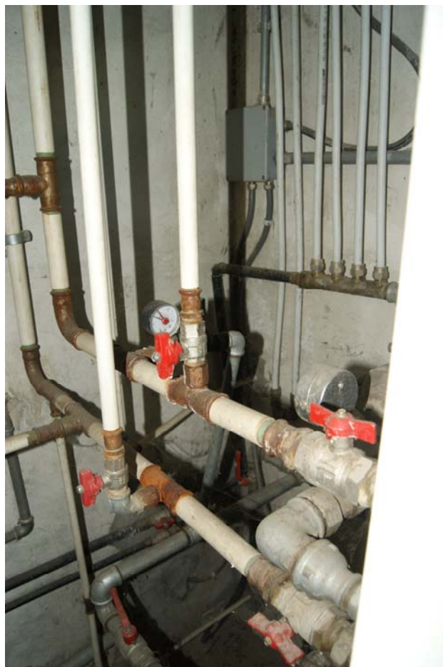
Tubazioni impianto idricosanitario esistente in C.T.
